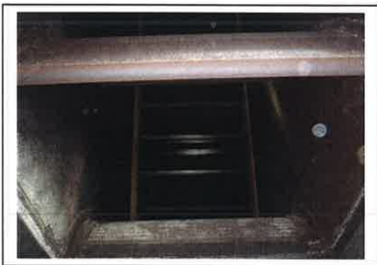
ID FAN DAMPERS - WEST
